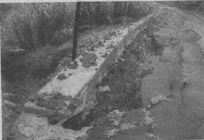
A erosão está a destruir o Caminho da Glória, no Campanário, que foi construído na década de 90. FOTO ORLANDO DRUMOND
